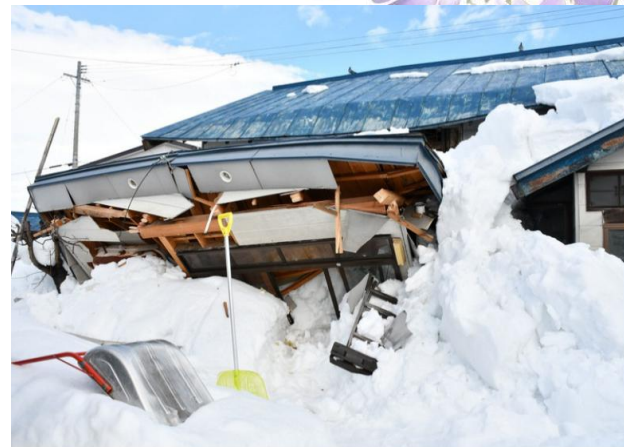
令和7年1月の大雪によりつぶれた民家 出典：陸奥新報
