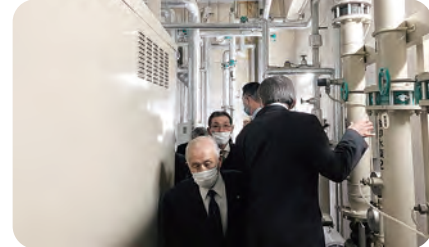
ふれあいずーむ館機械室
