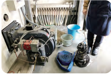
ふれあいずーむ館のボイラー
