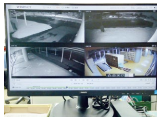
藤崎中学校の防犯カメラの映像
