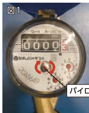
地下式水道メーター
